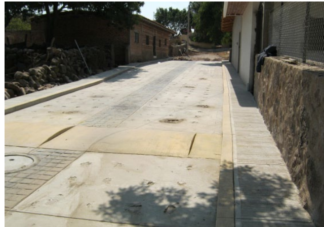
Pavimento de concreto hidráulico de la calle Alameda y la calle Fresnos en la localidad de La Rosa Amarilla, municipio de Tizapán el Alto, Jalisco.
