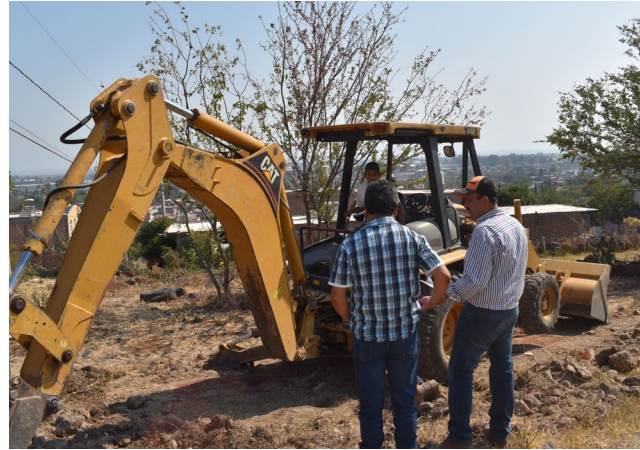
Construcción de parque en la colonia popular en el municipio de Tizapán el Alto, Jal.
