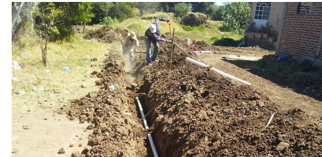
Red de agua potable en la calle Isla Raza.
