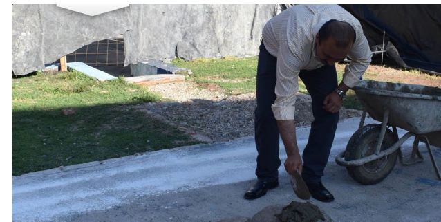
Programa de mantenimiento y construcción de comedores en distintas escuelas del municipio.
