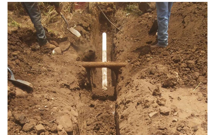
Construcción de red de alcantarillado y cárcamo de bombeo en la localidad de Mismaloya, municipio de Tizapán el Alto, Jalisco.
