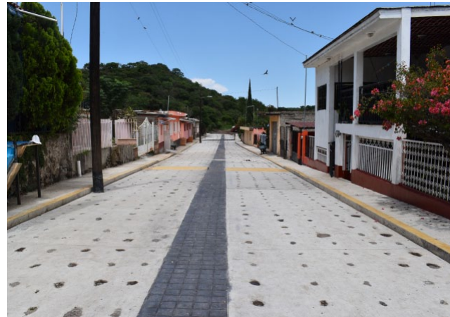
Pavimento de concreto hidráulico en la calle San Miguel en la localidad de El Refugio, municipio de Tizapán el Alto, Jalisco.
