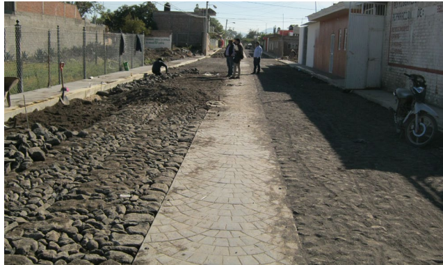
Construcción de pavimento de empedrado tradicional en la calle Plan de Ayala en el municipio de Tizapán el Alto, Jalisco.
