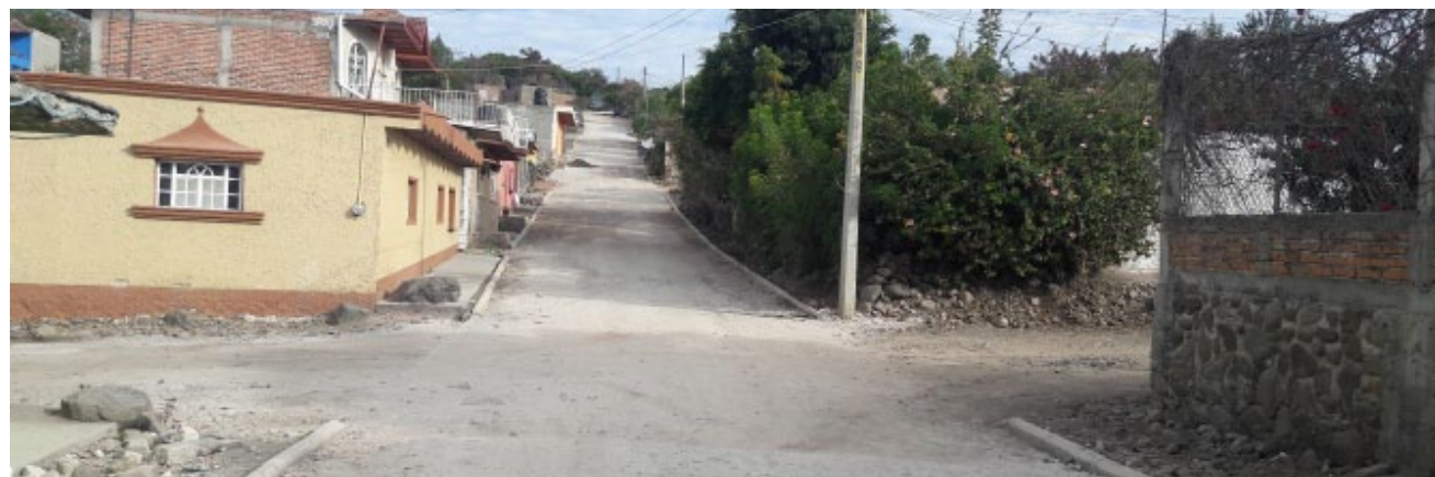
Rehabilitación de línea de agua potable, empedrado tradicional y drenaje en la calle Francisco Villa en la localidad de Villa Emiliano Zapata.
