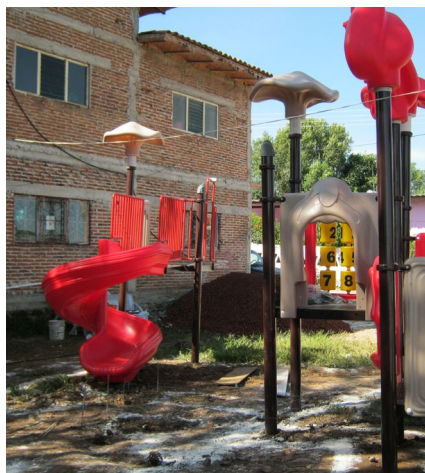
Construcción del parque lineal en la delegación de El Volantín, municipio de Tizapán el Alto, Jal.
