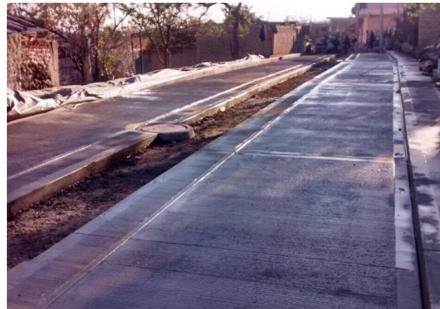
Construcción de pavimento de concreto hidráulico en la calle Melchor Ocampo en la localidad de El Volantín municipio de Tizapán el Alto, Jalisco.
